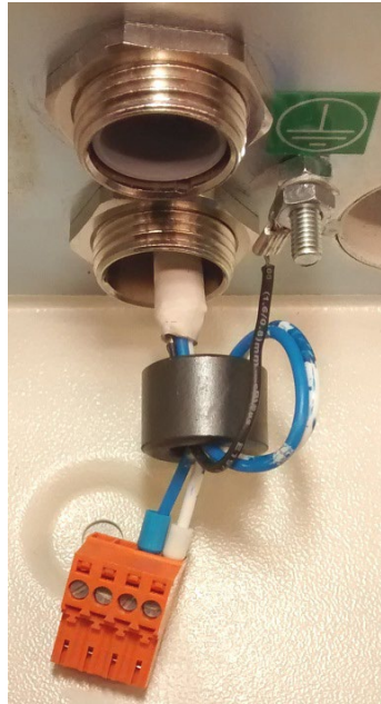
Figure 8 : enroulement des câbles de connexion de relais autour d'une ferrite de suppression
